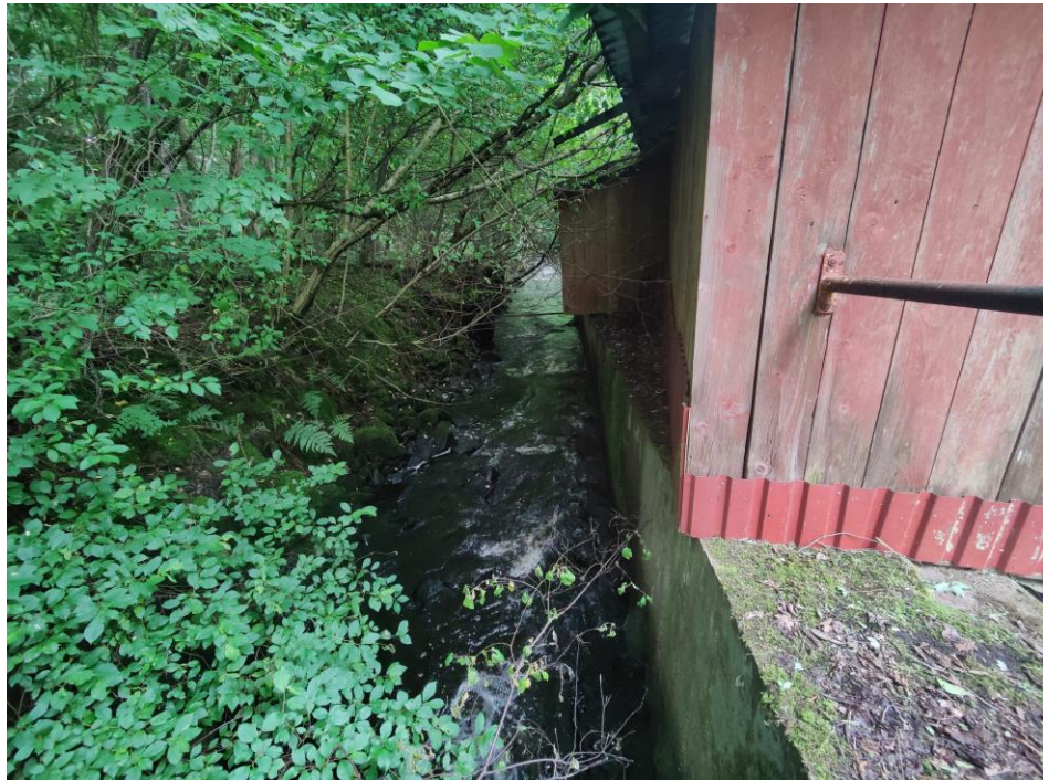
Figur 8. Betongmur på höger strand och rensvall på vänster strand tränger ihop Stockån nedströms Okome kvarn.
