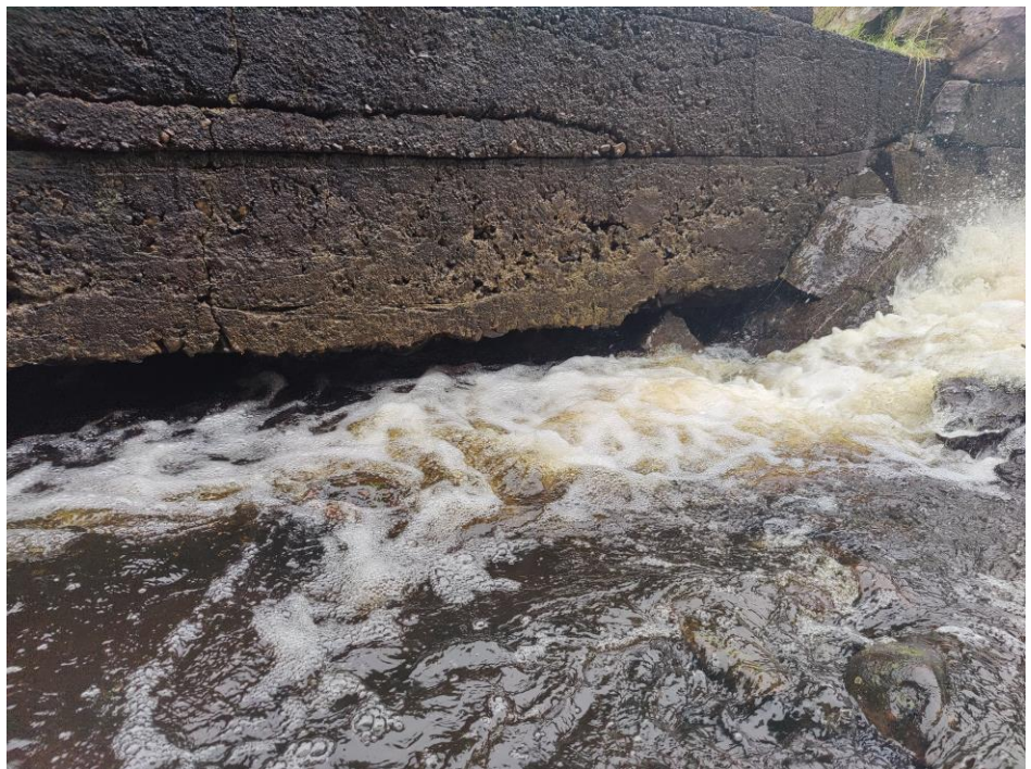
Figur 9. Erosionsskador på betongmur direkt nedströms dammval-len.
