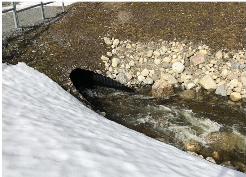
Figur 18. Exempelbild på kulvert under väg vid ett omlöp i Billstaån, Indalsälven.
