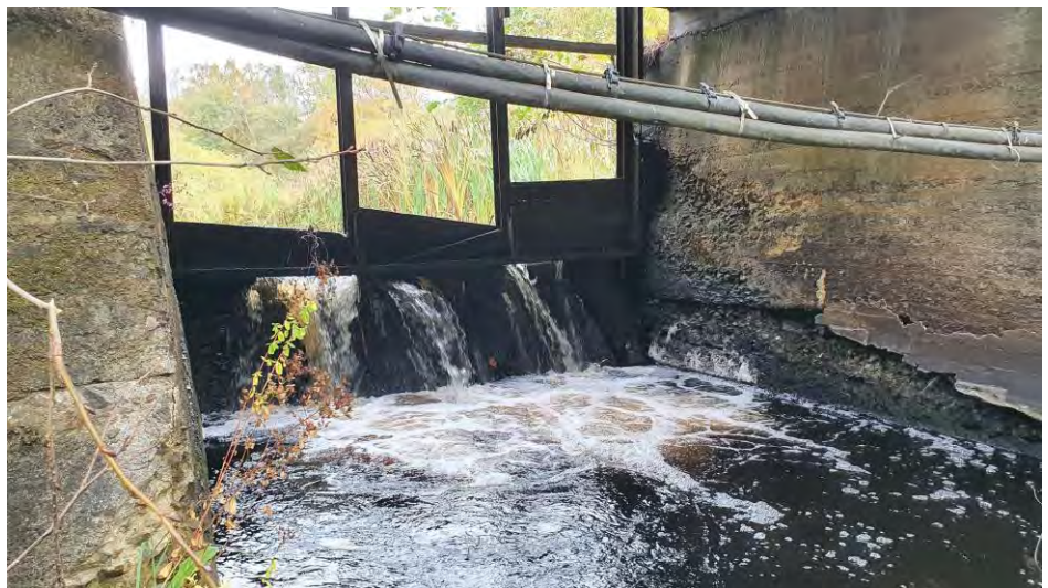
Figur 6. Läckage förekommer genom utskovet och dämmningspåverkan är minimal. Vattenföring ca 0,3 m 3 /s.
