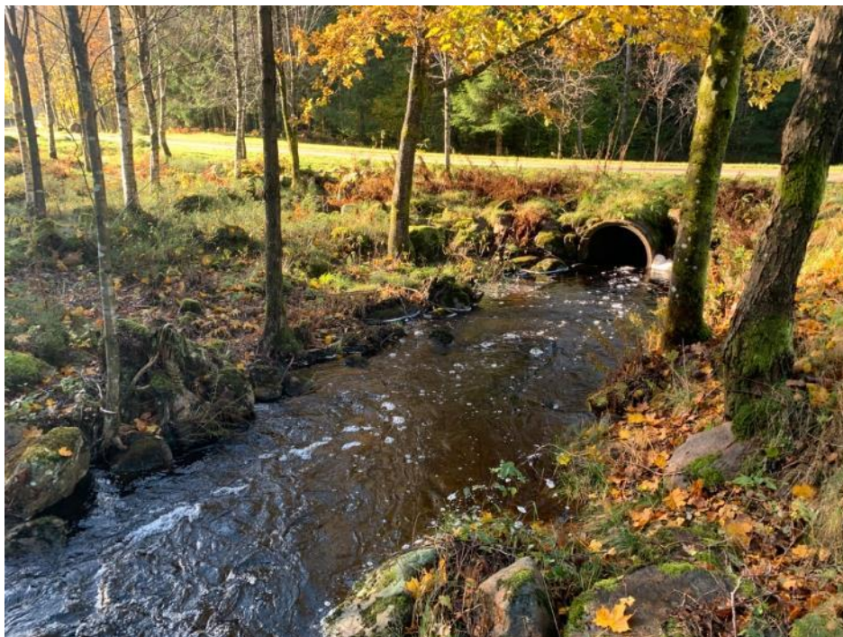
Figur 21. Uppströms mynning kulvert, naturfåra
