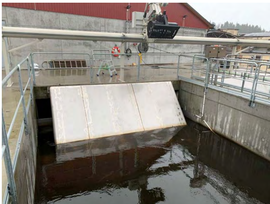
Figur 3. Vänstra intaget Fridafors övre. I bilden syns skrapplåten som ansluter mot fingallret. På vardera sida om skrapplåten finns flyktöppningar.
