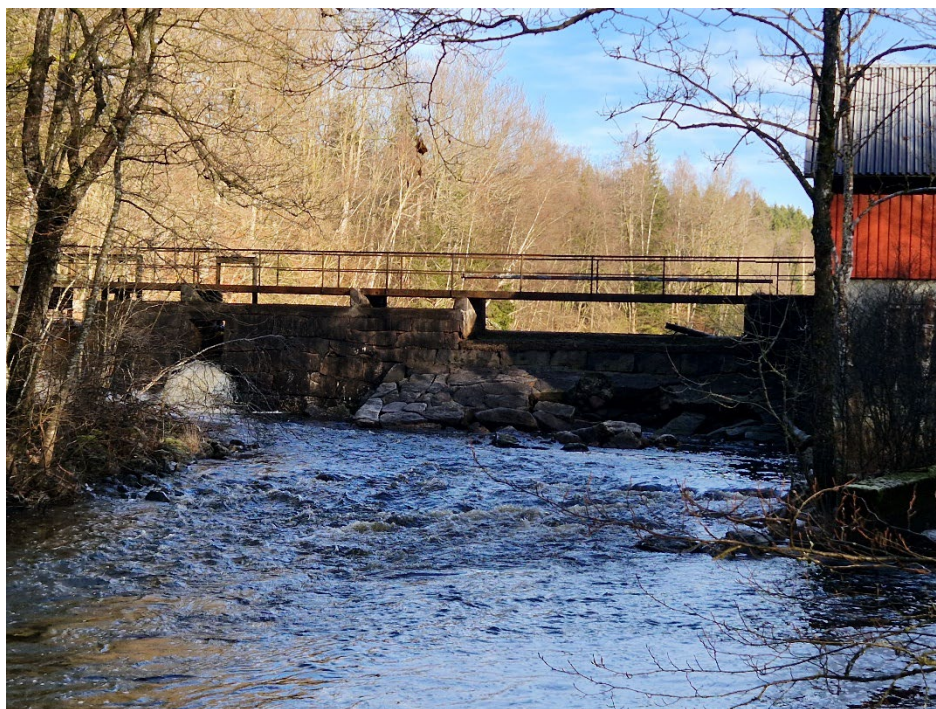
Figur 3. Dammvallen är uppbyggd av huggen sten med en betonggjuten överyta och uppströmssida. Graniten vid skibordet t.h. har börjat rasa på nedströmssidan.
