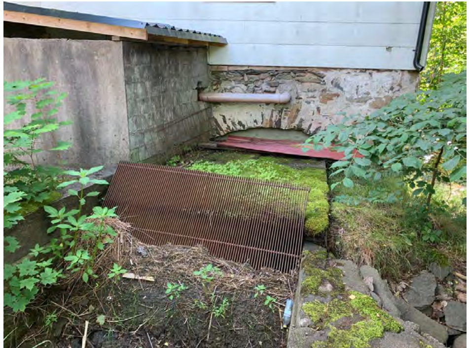
Figur 6. Vänster kvarnintag är till större del igensatt av sediment och växtdelar.
