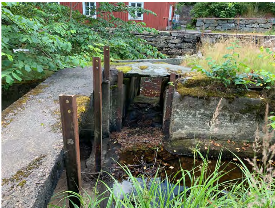
Figur 4. Betongklack och flodutskov i vänster intagskanal.
