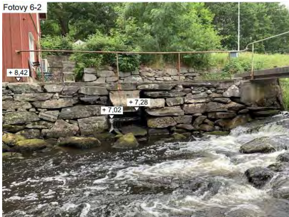
Figur 26. Vid vattenstånd över +8,42 står vatten mot träfasaden på höger kvarnbyggnad. Skärmutsnitt, bilaga 06.
