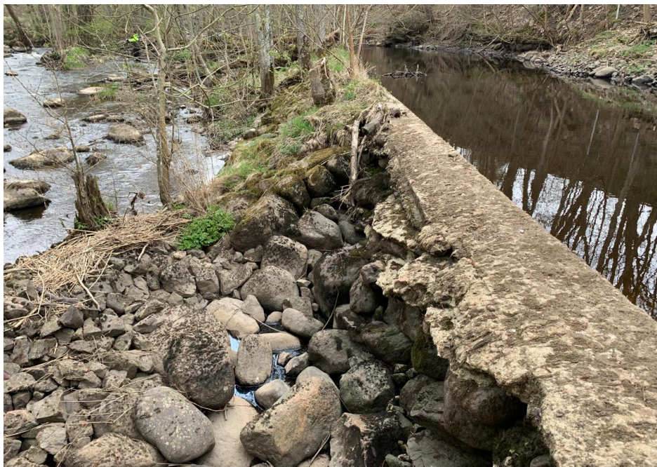
Figur 4. Dammvallens övre delar utgörs av en fyllnadsdamm i sten med betongförstärkning på uppströmssidan. Uppströmsvy ungefär mitten av dammen.
