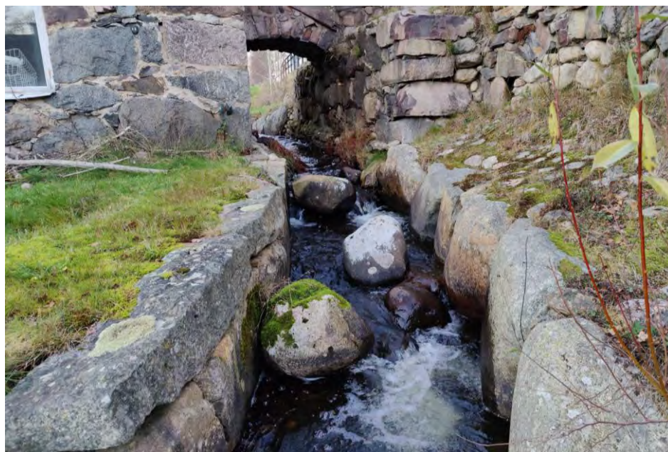
Figur 14. Fiskvägen passerer in till den gamla kvarnbyggnaden vilket riskerar att orsaka skada på byggnaden. Sidorna är stensatta och botten utgörs av sten samt några block.
