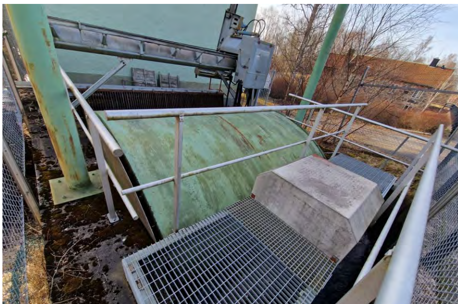
Figur 10. Från intaget leds vattnet till kraftverket där en kaplanturbin är installerad, nedströmsvy.
